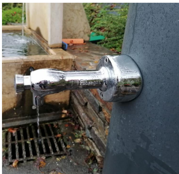
Photographie de robinet Poli GRIF 10 sur fontaine d'eau potable extérieure (Castelnau de Mandailles, 12)
